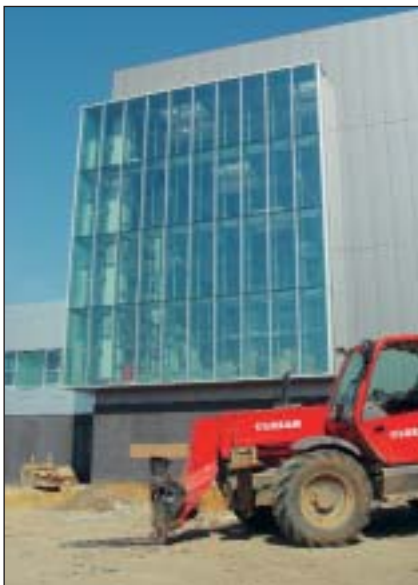
Le nouveau centre d'impression de Rossel. Derrière l'immense baie vitrée se cache la nouvelle rotative du groupe.
